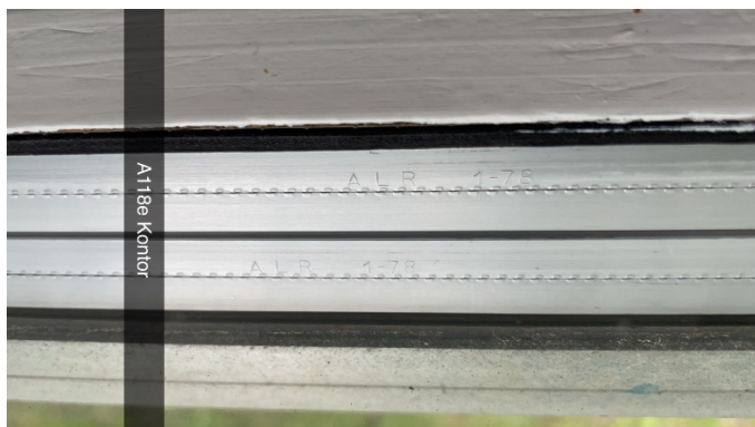
Bilde B38: Vindu med PCB fra 1974. B120 Gymsal.
