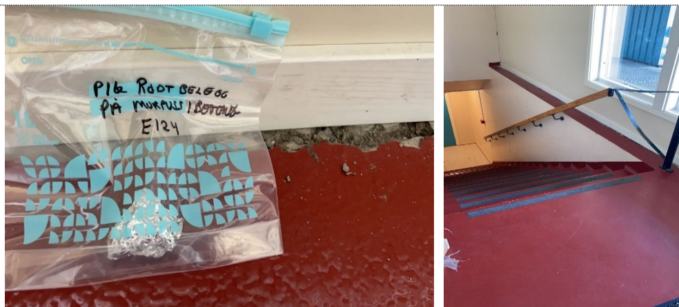
Bilde B16: P16 Rødt belegg på murpuss/betong. E124 Vestibyle.
